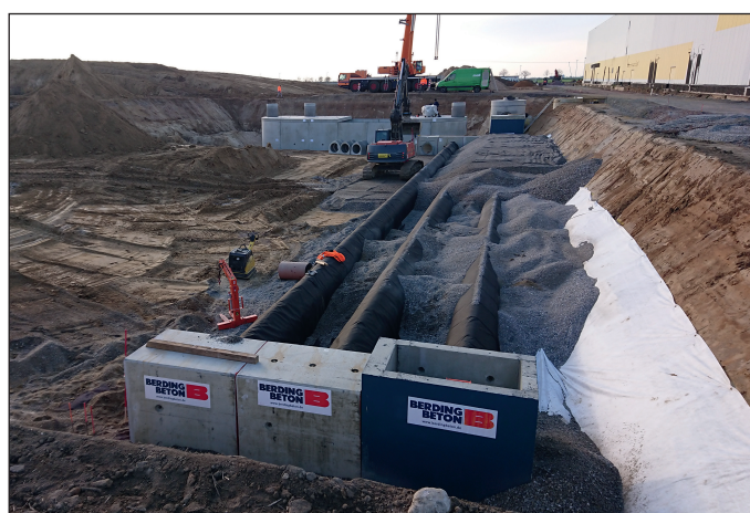
Abb. 7: Versickerungsgalerie Airportpark/Watzschkenbreite Schkeuditz
